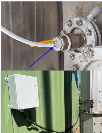
Abb. 3. Installiertes Gerät mit Messsonde (oberes Bild) und Messbox (unteres Bild).
